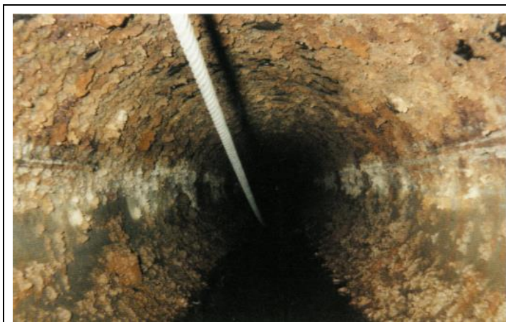
Внутренняя поверхность трубопроводов до очистки от продуктов коррозии
